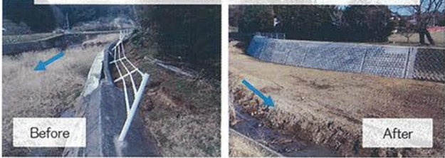
原瀬川 令和4年3月16日の地震で護岸が被災
